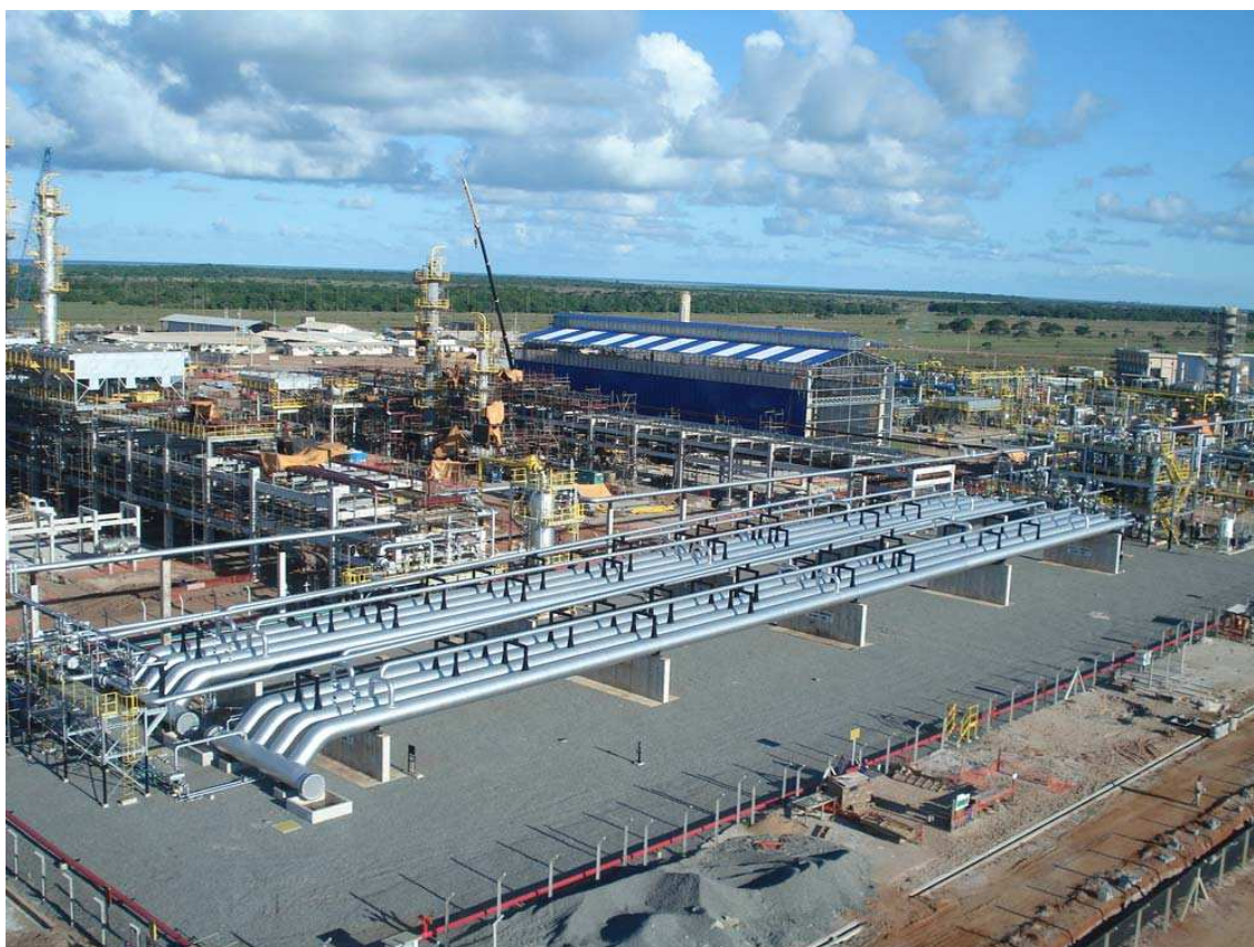
Figura 6: Unidade de Tratamento de Gás de Cacimbas - UTGC Fonte: Engevix (2010)
