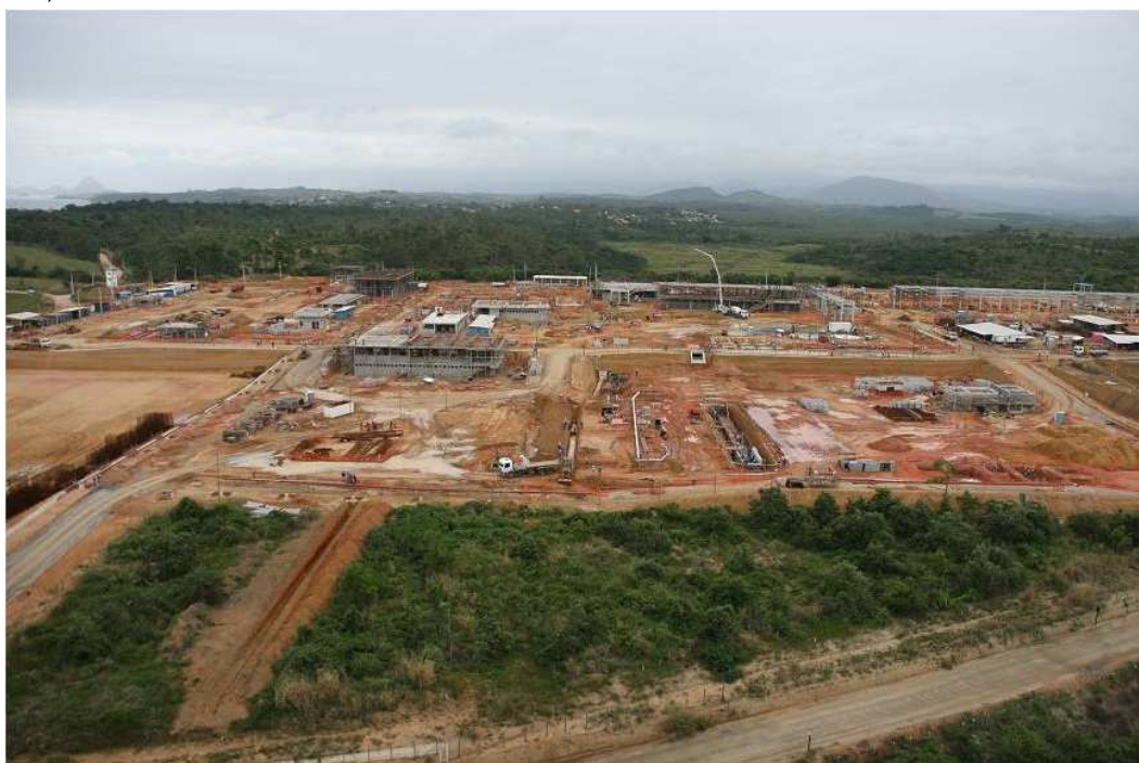
Figura 8: Vista geral Unidade de Tratamento de Gás de Cacimbas – UTG Sul, 2009.
