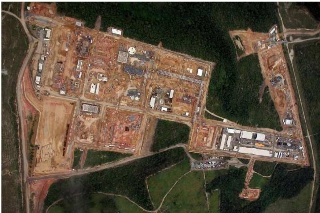
Figura 7: Vista aérea Construção da Unidade de Tratamento de Gás Sul Capixaba – UTG Sul, 2009.
